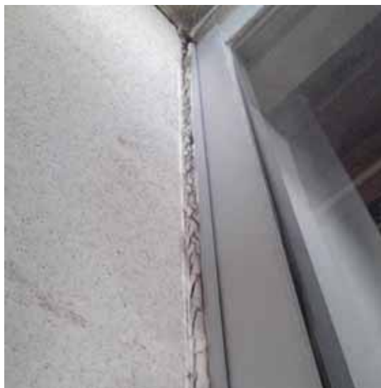
写真4 <窓廻りシーリング材の劣化>
