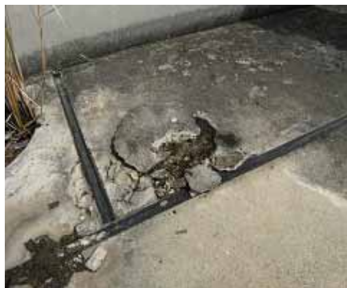
写真2 <保護層（押さえコンクリート）の割れ>
