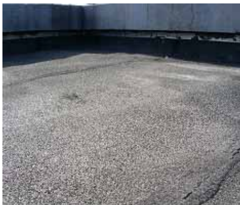
写真1 <露出防水層の膨れ>
