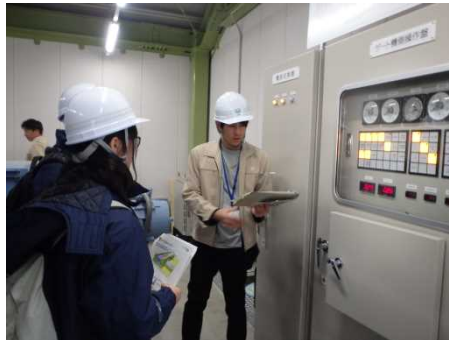
水門操作盤の説明
