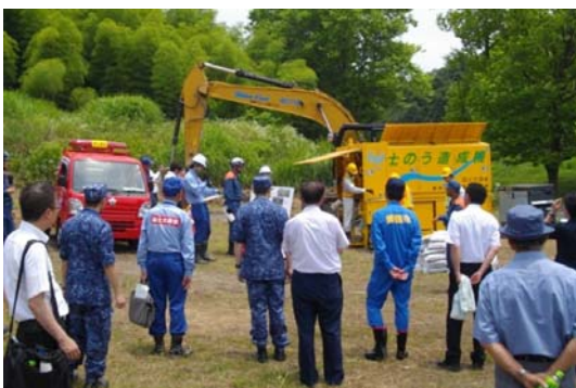
【土のう造成機を配備】
