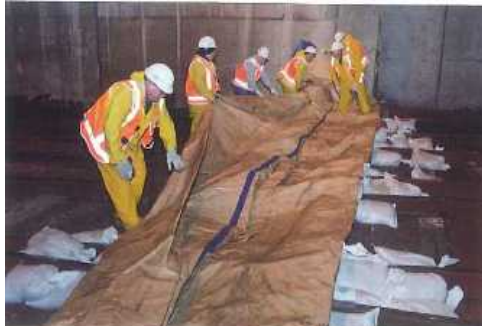
ハリケーン・サンディでの地下鉄会社の浸水防止の取組 (水のうによる止水対策)
