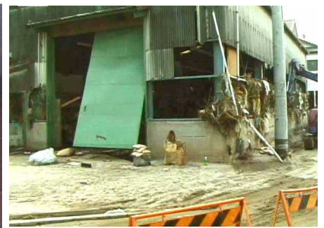
洪水流で破壊された工場
