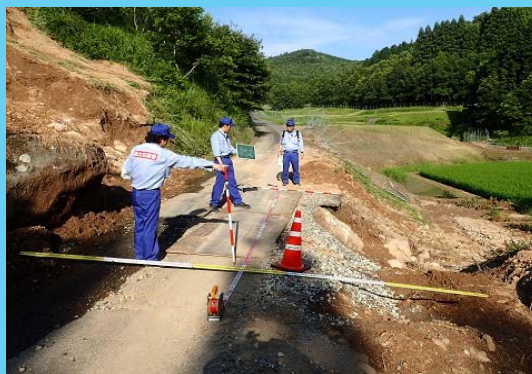
◀道路の被災状況 調査 (大分県日田市)
