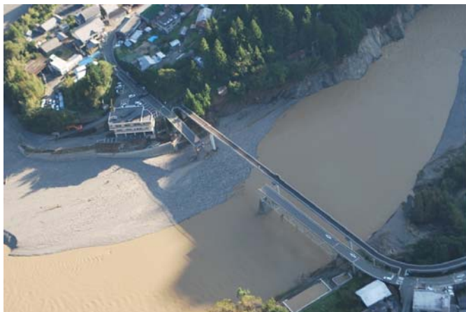
■落橋した折立橋
