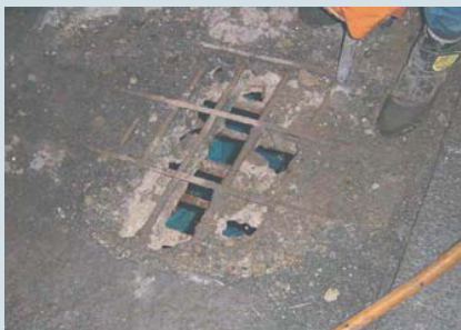
(橋の床版が損傷し抜け落ちた状況)
