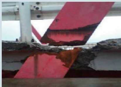
(トラス橋の斜材の破断)【木曾川大橋】
