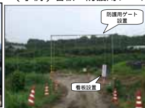
(事例) 看板・防護用ゲート
