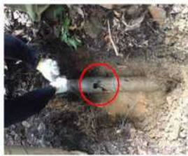
事故状況写真②
