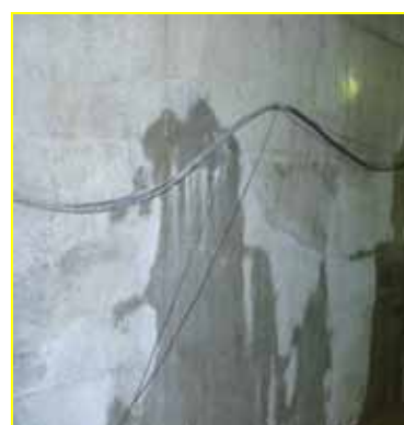
写真3 ジャンカ補修部 の漏水
