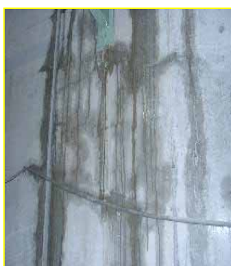
写真2 コールドジョイ ント部の漏水
