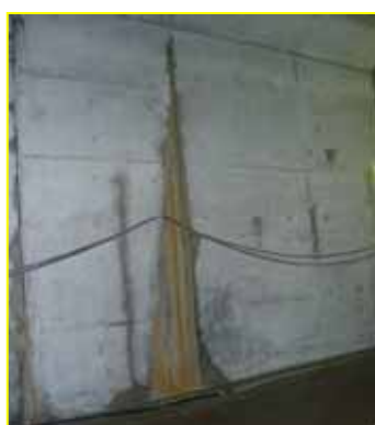
写真1 ひび割れおよび セパレーター部の漏水
