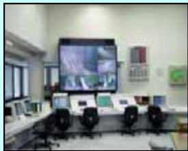
ゲート制御設備
