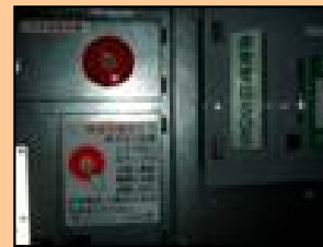
トンネル非常用設備
