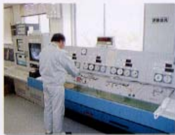
▲ゲート遠方操作盤
