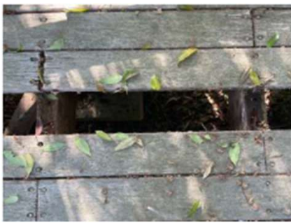
【あじさいエリアデッキ】腐朽
