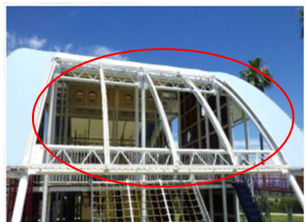
【夢っこランド】ドームテント剥がれ
