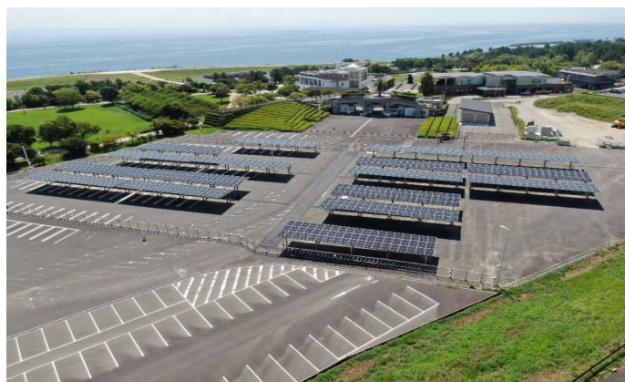
太陽光発電施設
