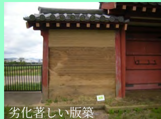
劣化著しい版築
