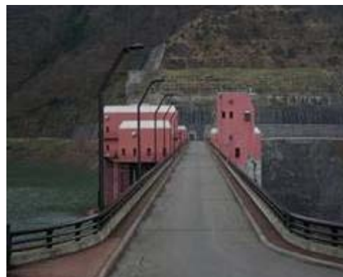
照明設備写真（他ダム事例）
