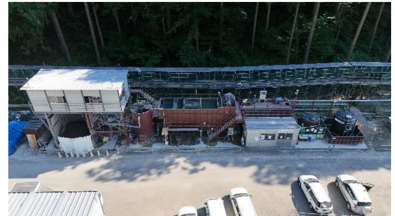
濁水処理設備
