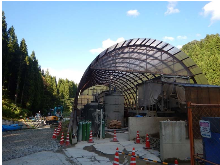
トンネル工事濁水プラント
