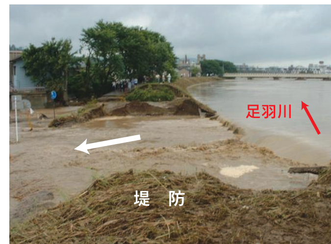
堤防の決壊状況(福井市春日)
