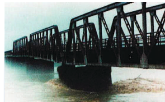
昭和56年7月洪水(梅雨前線)洗掘のため傾いた高屋橋(県道福井三国線)の橋脚
