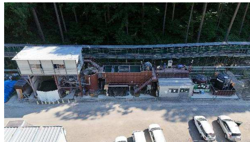
濁水処理設備
