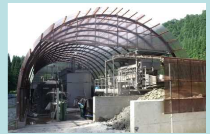
濁水処理施設
