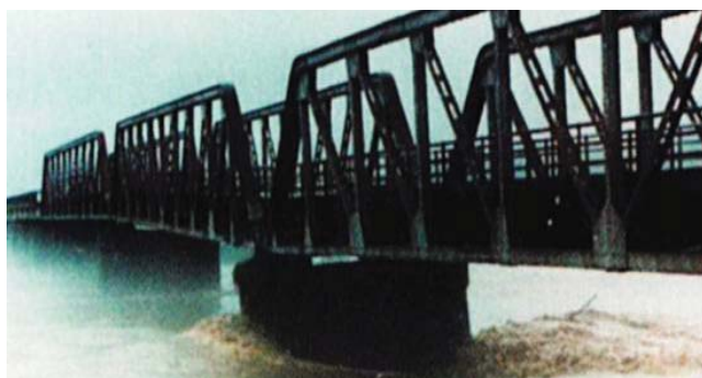
昭和56年7月洪水（梅雨前線） 洗掘のため傾いた高屋橋（県道福井三国線）の橋脚
