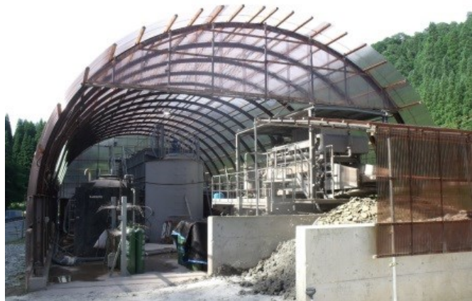
濁水処理施設
