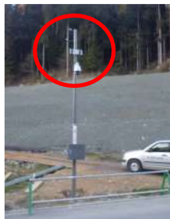
監視カメラ設置状況
