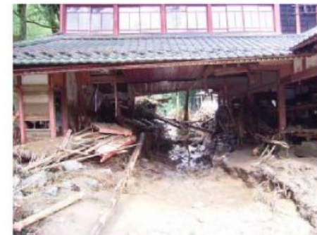
【破堤によるはん濫水により損壊した家屋 (福井県池田町)】
