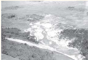
野洲川北流堤防の決壊現場（現野洲市六条） 出典：「野洲川の歴史と文化」水害碑一覧
