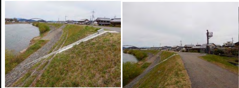
危機管理型水位計の設置状況
