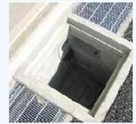
設置している雨水浸透ます
