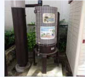
設置している雨水貯留タンク
