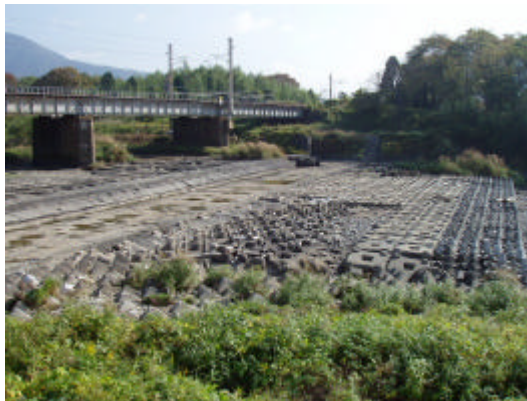
写真⑧ H15. 11. 7、JR北陸本線直下 の落差工、瀬切れ発生状況
