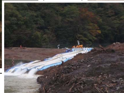
ポンプ排水状況
