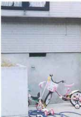
新潟市関南 床下換気口の位置で、基礎を高くしていることがわかります。
