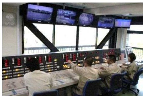
瀬田川洗堰操作室
