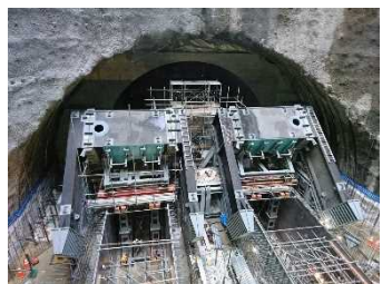
地下50mに並ぶ機械設 (H30.2)
