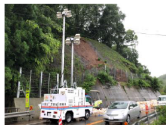
梅雨前線による土砂崩れ箇所の監視（H30. 7）＜京都府＞
