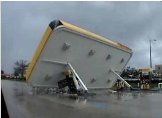
構造物の倒壊
