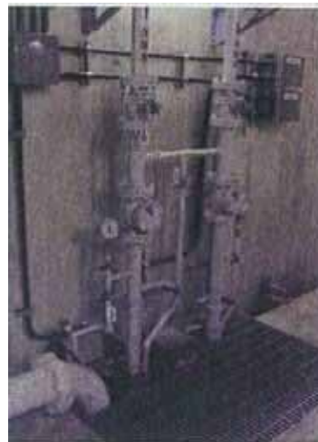
B2 排水ポンプ
