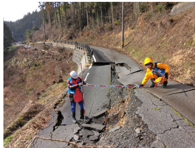
【道路班】輪島市 被災状況調査（10日）
