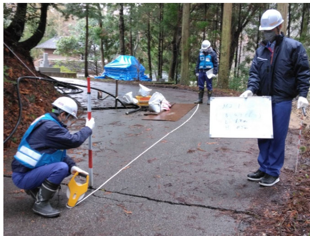
【道路班】輪島市 被災状況調査（20日）
