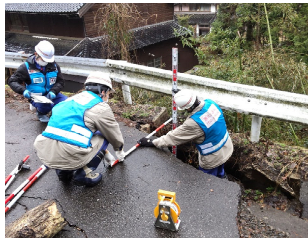
【道路班】輪島市 被災状況調査（20日）
