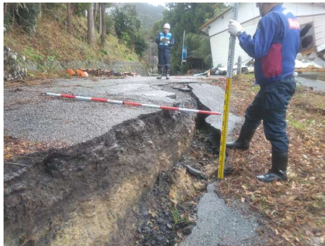
【道路班】輪島市 被災状況調査（8日）
