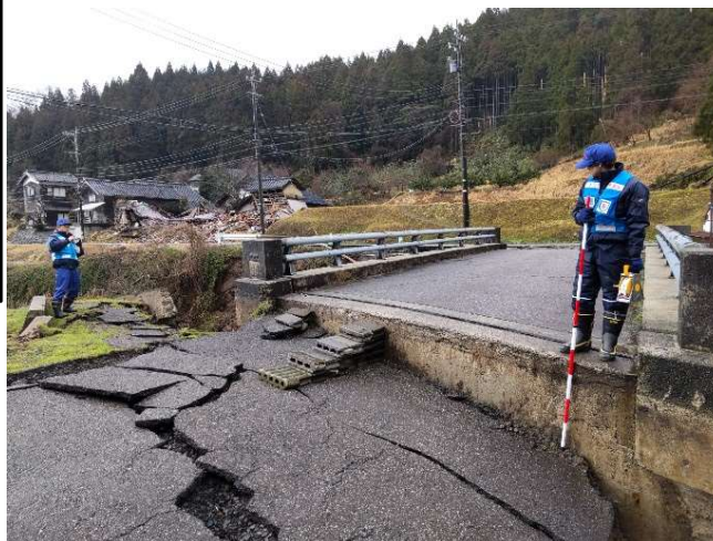
【道路班】輪島市 被災状況調査（8日）
