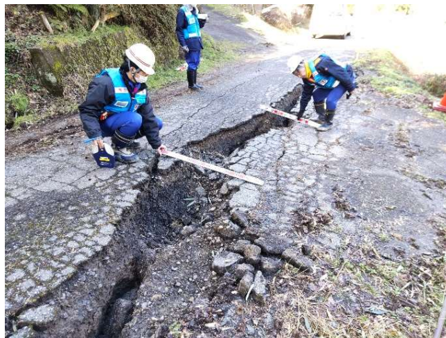
【道路班】輪島市 被災状況調査（16日）
