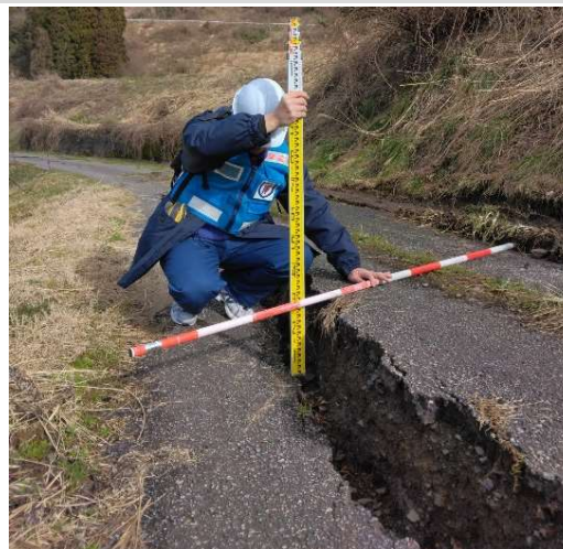
【道路班】輪島市 被災状況調査（16日）
