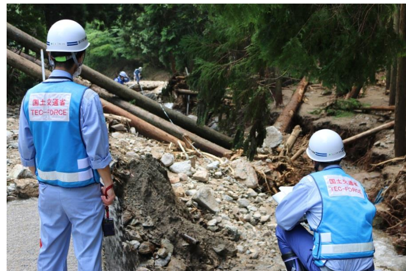
7/10 福知山市内での被災調査状況
