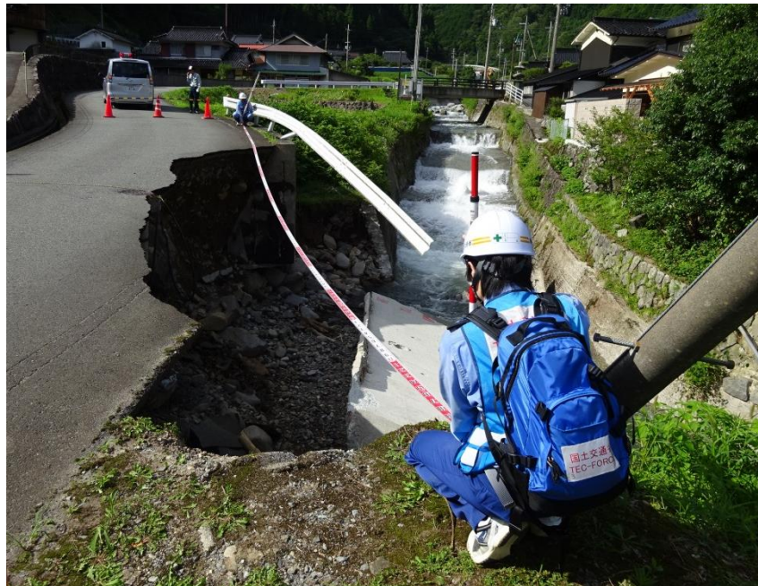
7/10 宮津市内での被災調査状況
