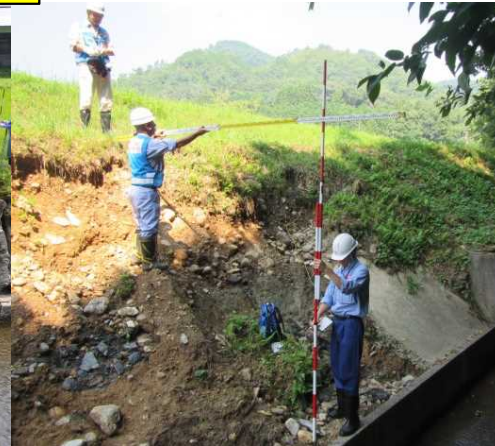
7/18 法面崩壊状況調査
