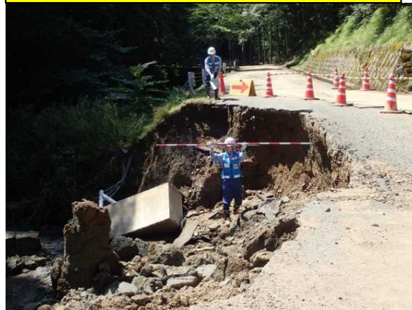
7/15 道路崩壊状況調査
