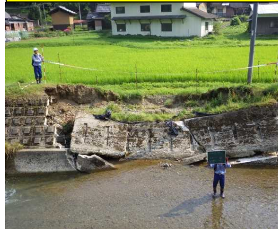
7/17 護岸崩壊状況調査
