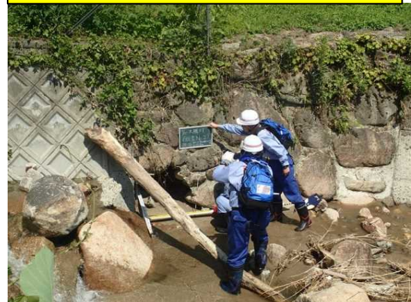
7/14 護岸崩壊状況調査
