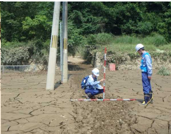
7/17 道路土砂堆積状況調査
