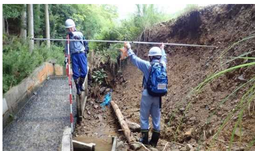
7/20 護岸崩壊状況調査
