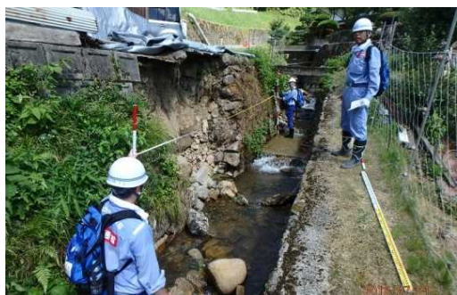
7/21 護岸崩壊状況調査
