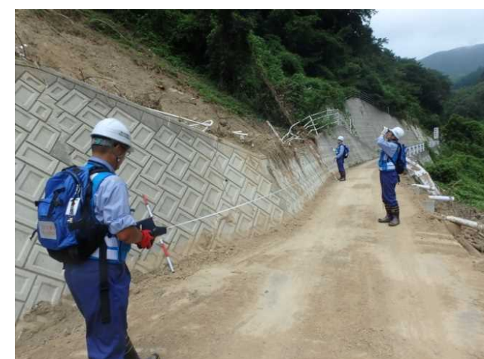
▲土砂崩落状況調査(宇和島市)
