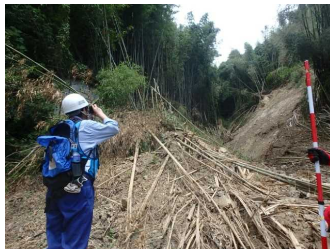
▲土砂崩落状況調査(宇和島市)
