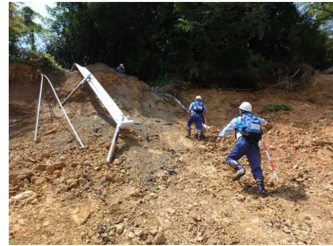
▲斜面崩壊状況調査(大洲市)
