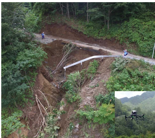
①ドローンによる上空からの被災状況調査 (岩手県・宮古市)
