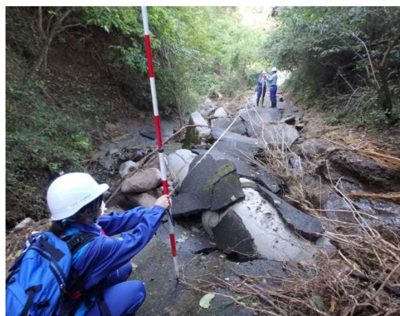
■10/15 道路被害状況調査（長野県小諸市）
