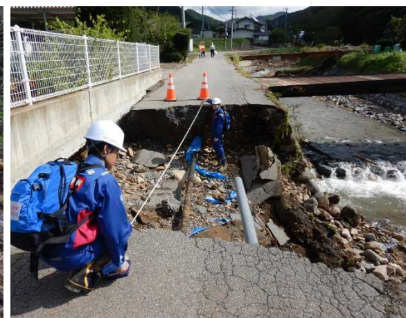
■10/15 道路被害状況調査（長野県佐久市）
