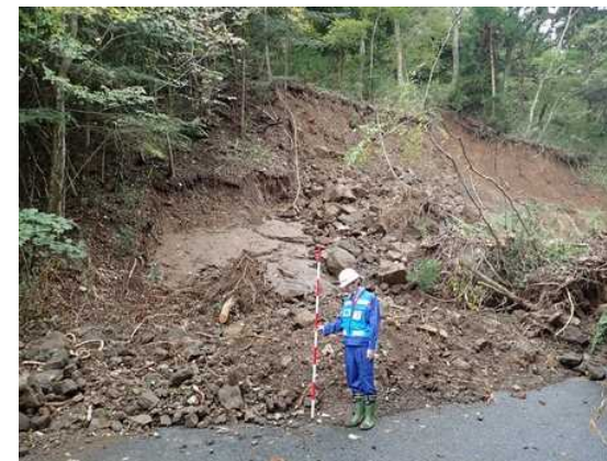
■10/27 道路被災状況調査 (福島県相馬市)
