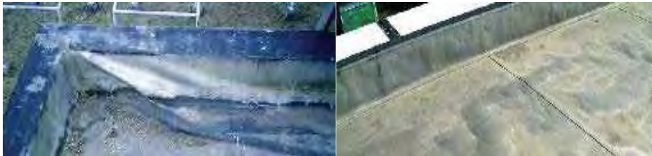
露出防水の劣化状態（防水層が膨らんでいる場合、点検時に踏んで損傷させないでください）
