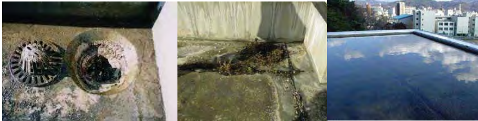
ルーフトレンの詰まり(1) ルーフトレンの詰まり(2) 詰まりによる排水不良 (屋上に草木が生えている場合がありますが、防水層を痛めるような引抜きはしないでください)
