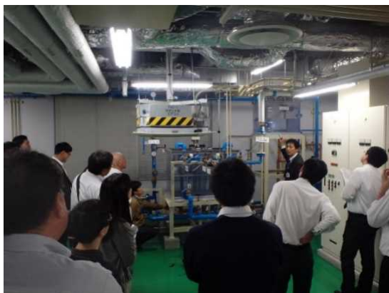
実際の建物の設備機器を見ての勉強会
