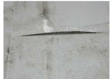
シート防水層のはがれ
