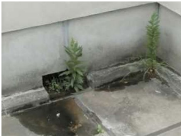
排水口の詰まり
