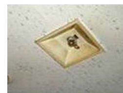
非常用照明の 球切れ状態
