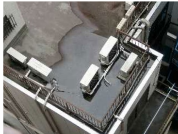
屋上の水たまり
