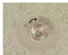
非常用照明 (異常なし状態)
