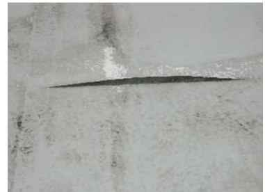
シート防水層のはがれ
