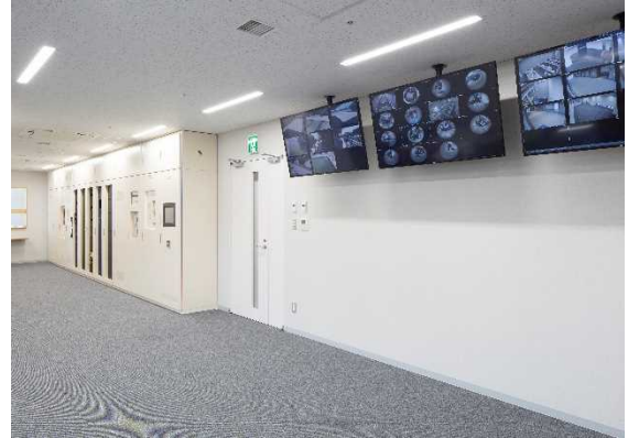
平城宮跡管理センター（中央監視盤）
