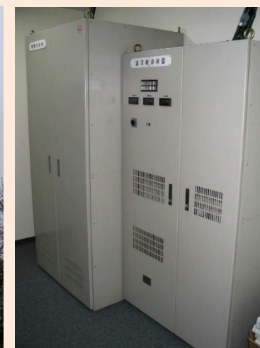
通信用直流電源装置
